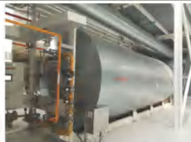
TNV 直接燃烧装置净化
