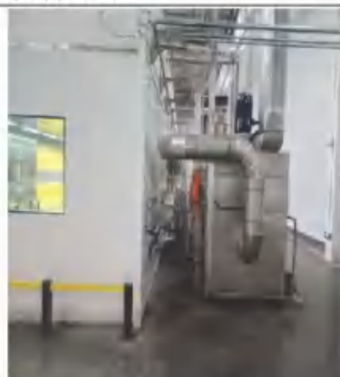
钢打磨房滤筒除尘器
