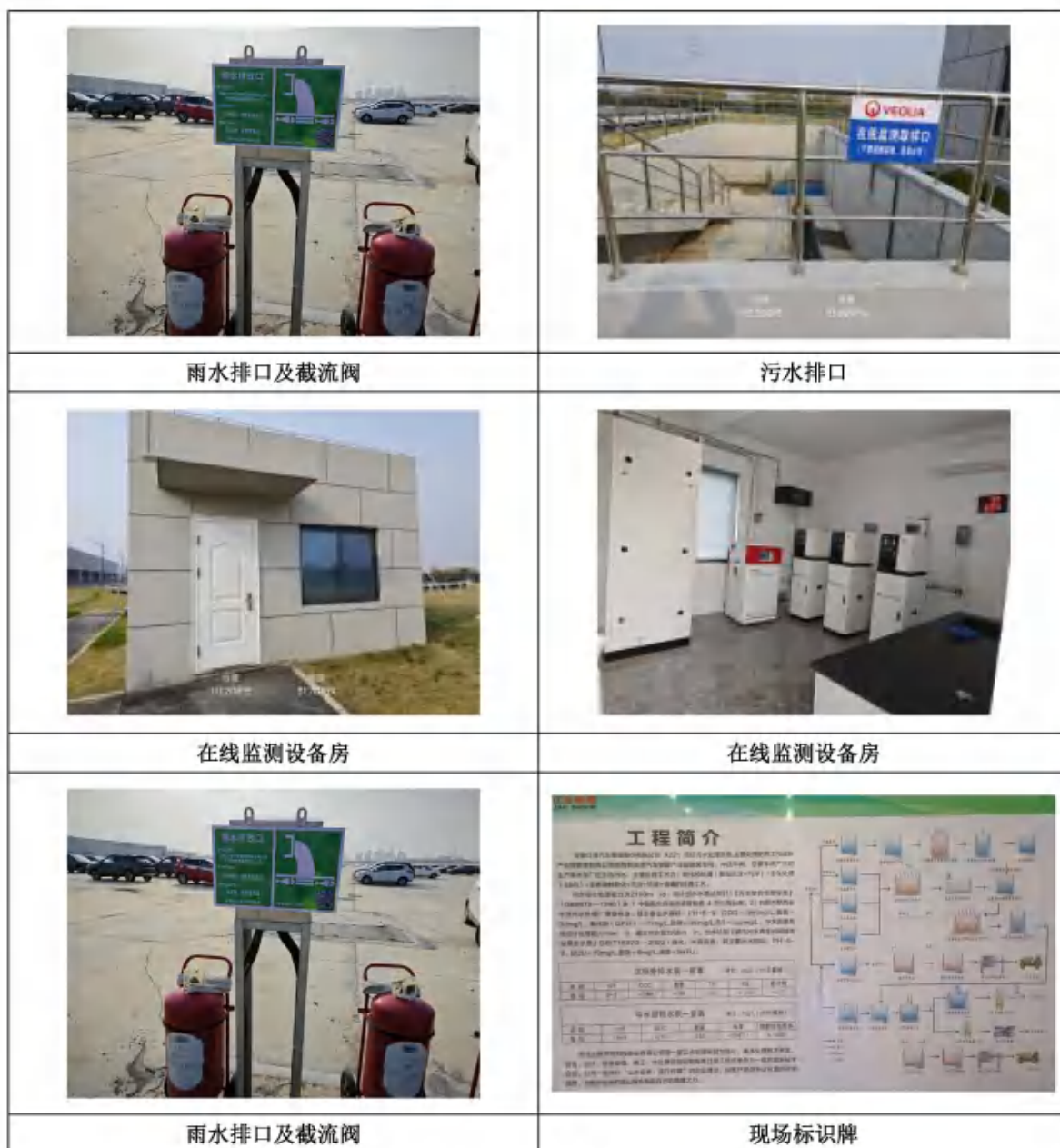
图4.1-3 废水处理措施照片
