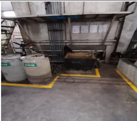
车间污水处理系统
