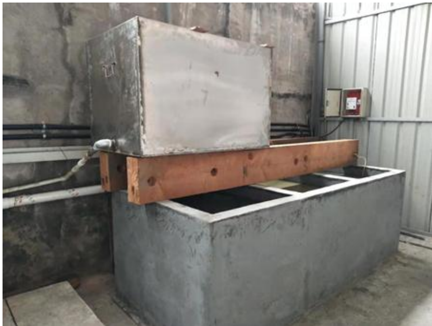
现有的磷化工段的水池为塑料水池，连接管道为软管
