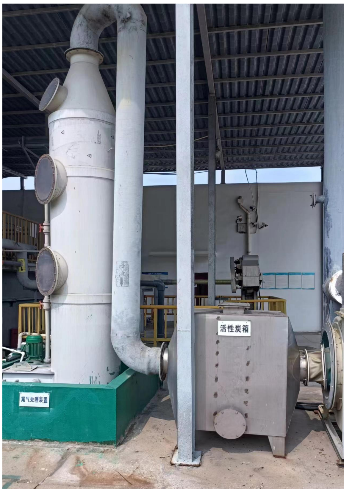
污水处理站废气处理装置
