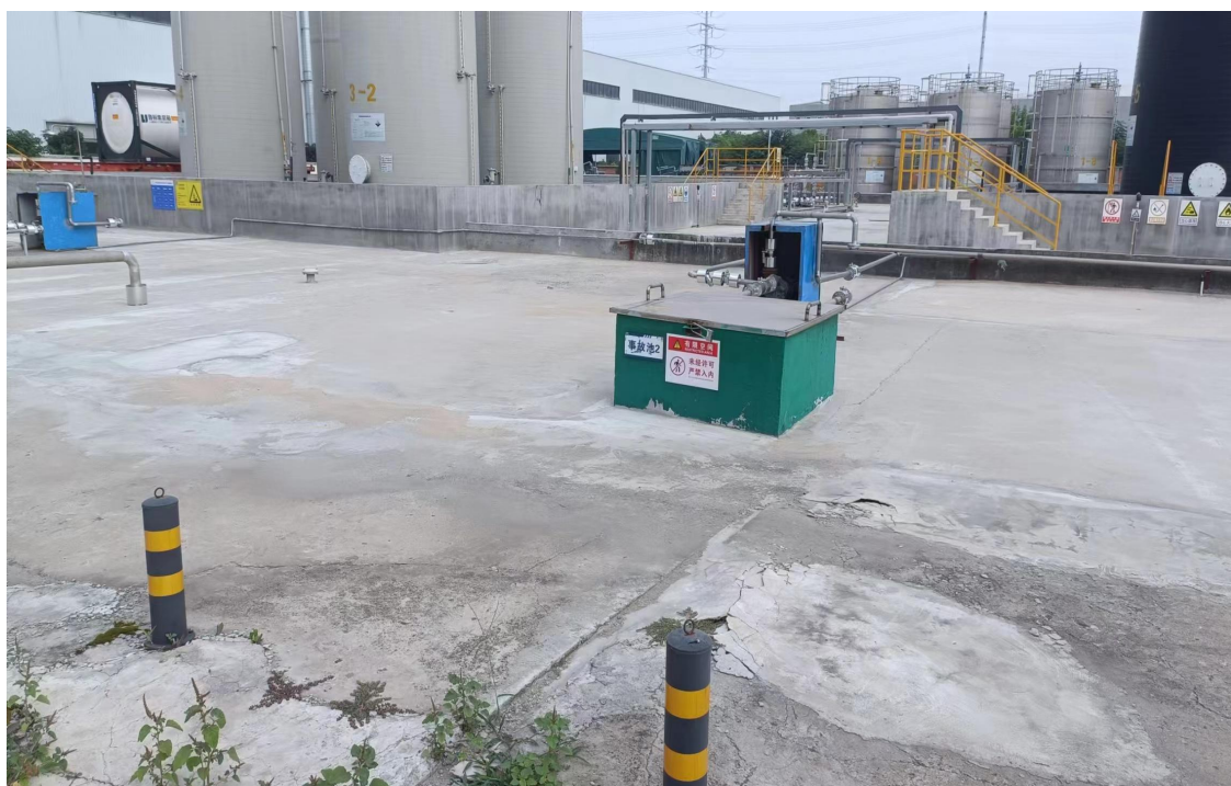
事故池 2 照片（地埋式）
