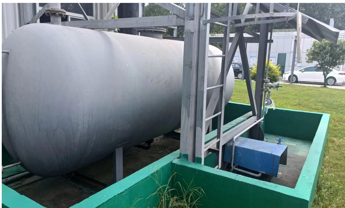
导热油炉、导热油中转罐及其废气排放口 DA002
