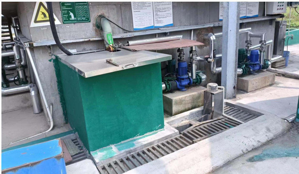
污水处总排口
