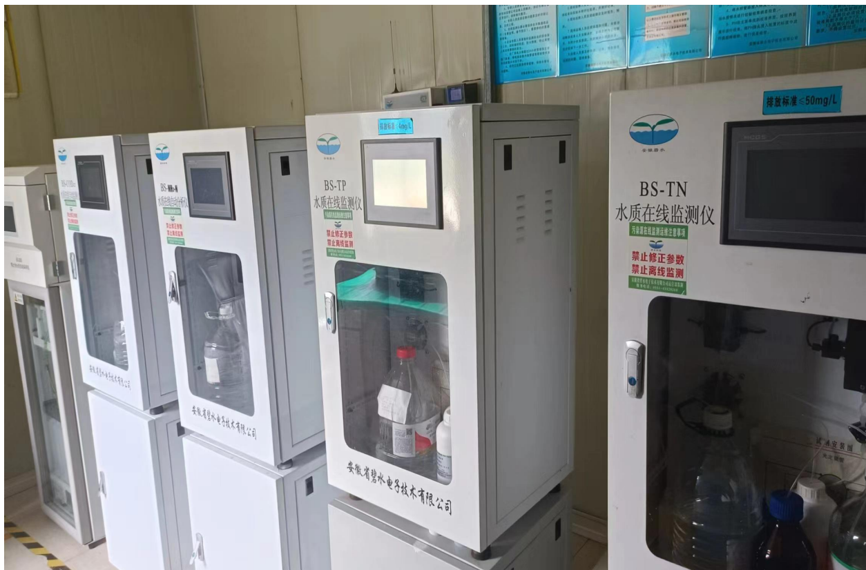
污水处理站在线监测装置
