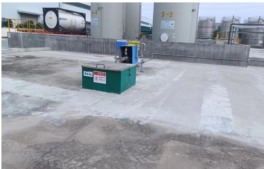
事故池 3 照片（地埋式）
