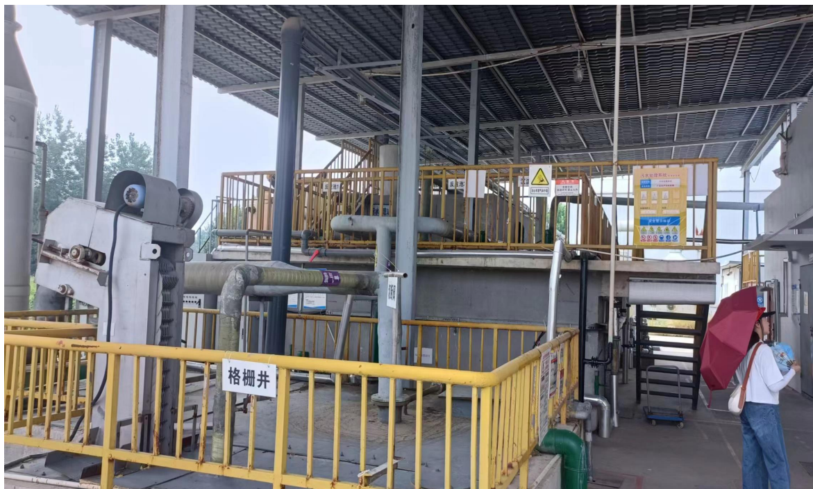
污水处理站照片
