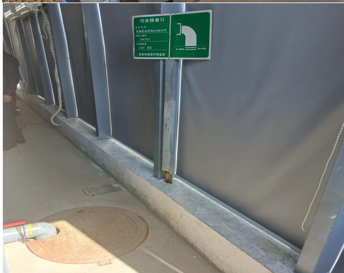
污水处理站及污水总排口照片
