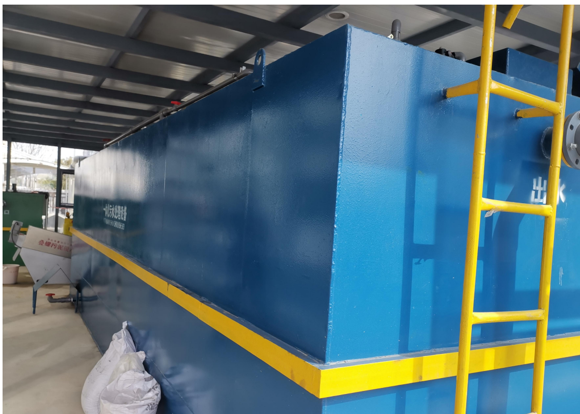
污水处理站照片
