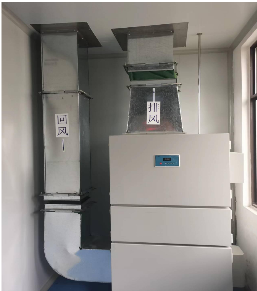
2#片剂生产线生产线粉碎、过筛袋式除尘器及其排气筒 DA003
