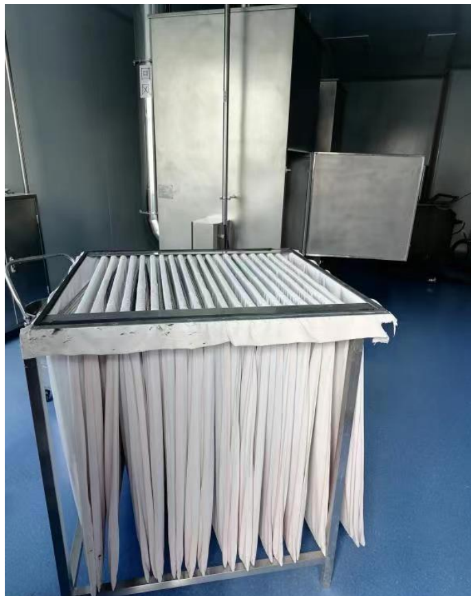
2#片剂生产线 1#沸腾干燥除尘器及其排气筒 DA004
