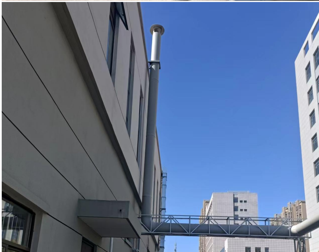
污水站废气治理设施（二级碱液喷淋塔+活性炭吸附装置）及其排气筒 DA007
